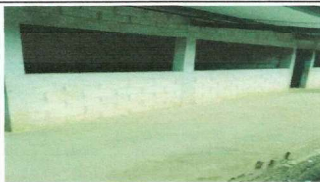
Foto 2: Colocacion balcones, pues los ventanales estan descubiertos.
